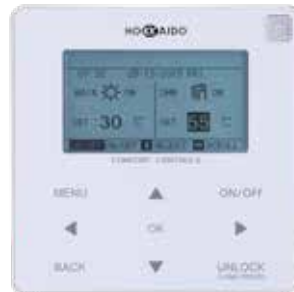
Modalità operativa RISCALDAMENTO + ACS
